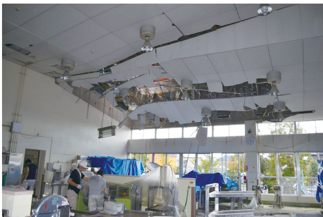
平成25年9月2日の埼玉県越谷市の竜巻被害 (埼玉県越谷市提供)
